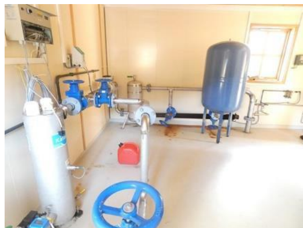
Figur 5 Utstyr i vannbehandlingsanlegget på Ose
