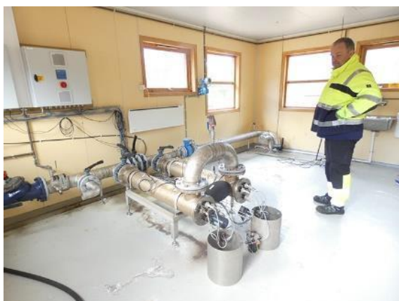
Figur 16 UV utstyr Bygland Vannverk
