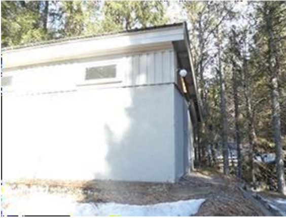
Figur 19 Bygg for det gamle vannverket som nå huser høydebassenget
