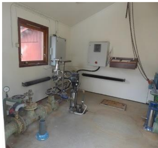
Figur 9 Utstyr ved vannverket med UV og klortilsetning
