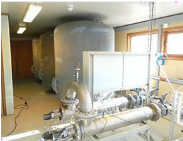
Figur 24 UV anlegg og kontakt tanker for nød-klorering
